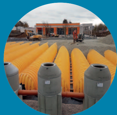
Das Rigolensystem ist begehbar und somit für Reinigungs- und Wartungsarbeiten leicht zu erreichen.
