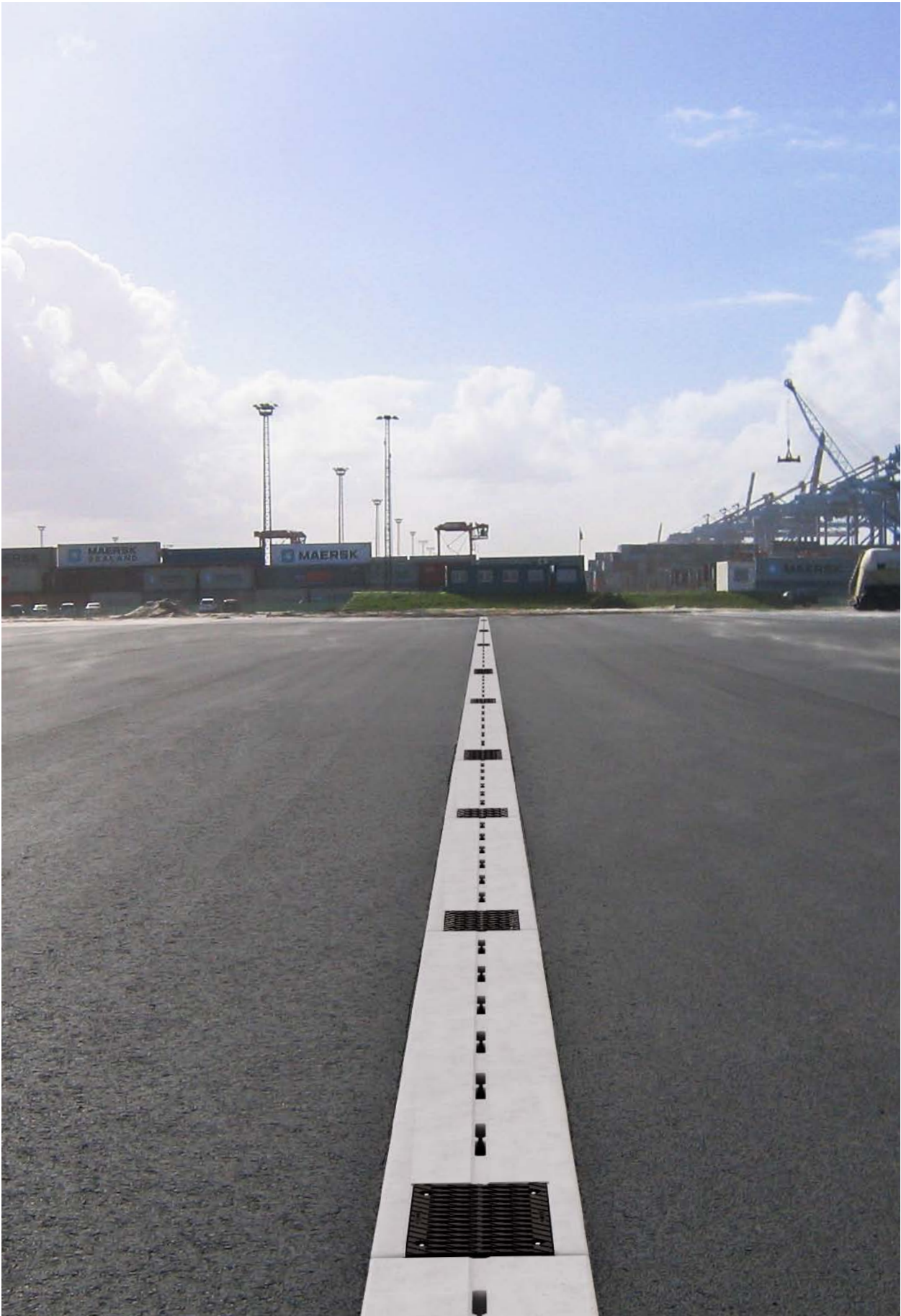
BIRCOsolid® Schlitzrinne zur Entwässerung einer Hafenanlage
